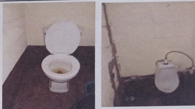
Foto 4: Servicios sanitarios y sus accesorios
